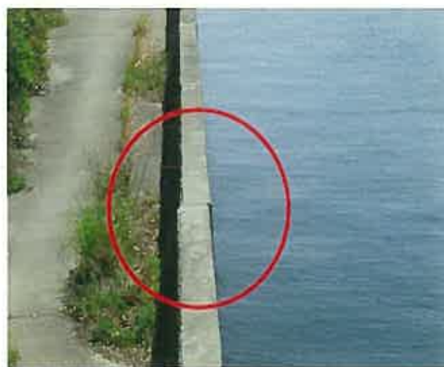
埋立地における護岸のずれ
