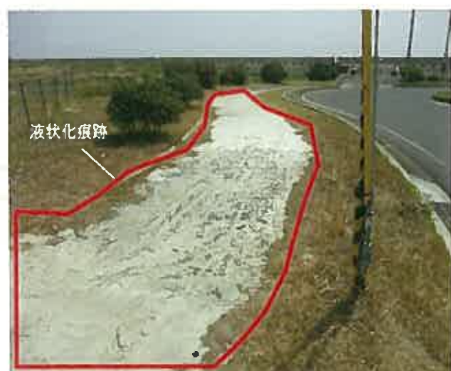
埋立地における液状化被害
